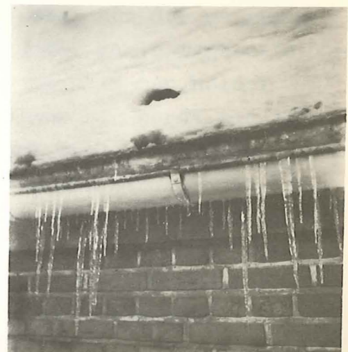
Fig. 10. Kendt fænomen, som viser de fugtskader, som kan opstå ved huse uden gavludhæng.
