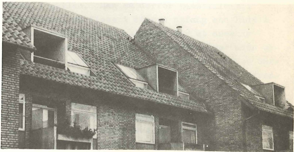
Fig.7. Uheldig anvendelse af forskelligartede materialer; betonkviste i forbindelse med tagkonstruktion af træ og for lavt placeret ovenlys i tagfladen.
